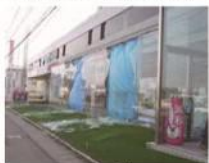
ショールームの壊れたガラス
