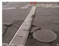
地割れた地面
